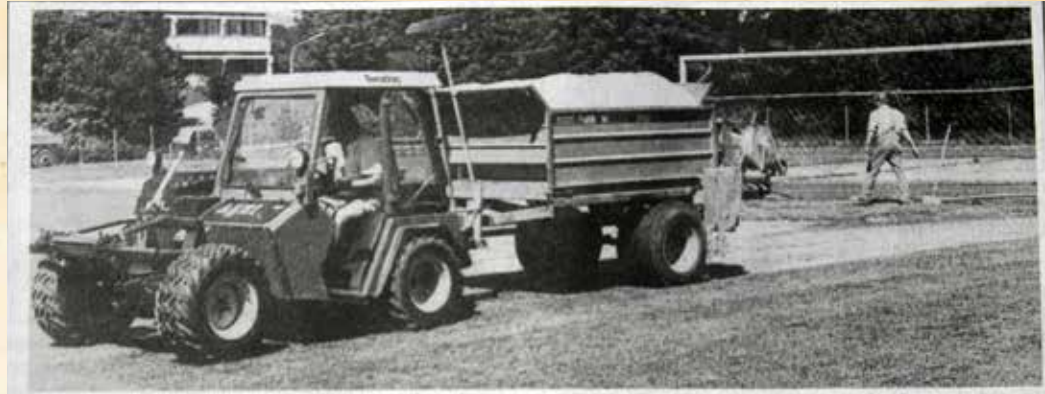
Zügig gingen die Sanierungsmaßnahmen im Schöllnacher Stadion vorstatten. Im Bild die „Sandmaschine“, dahinter ein Arbeiter, der den Torraum mit Rollrasen ausbessert. (Foto: Baier)
